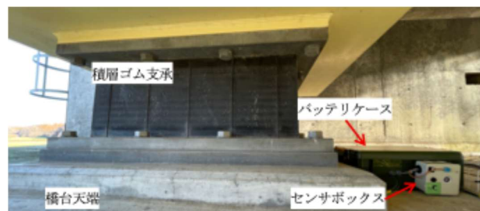
図-1 装置の設置状況
