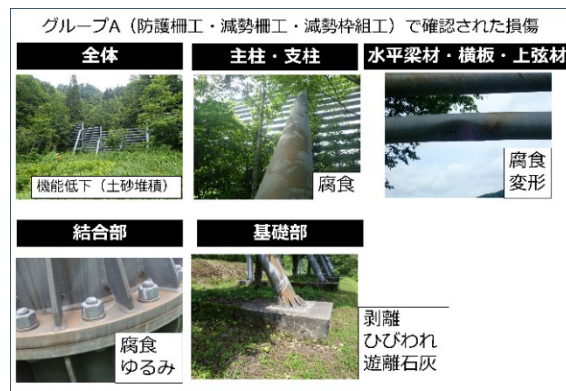
図-1 現地調査にてグループAで確認された損傷
