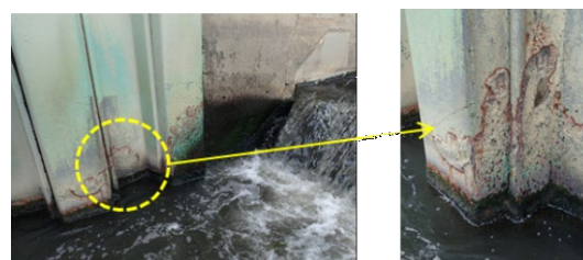
図-4 落差工付近の顕著な腐食
