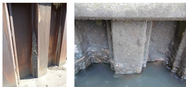
図-5 継手部からの 図-6 汽水域で見られたこぶ状さび 漏水による腐食
