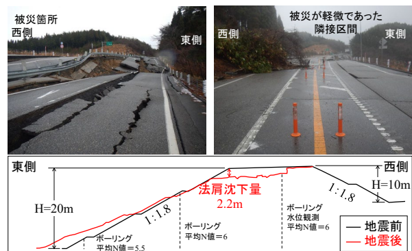
図-1 対象盛土の令和6年能登半島地震における被災状況
