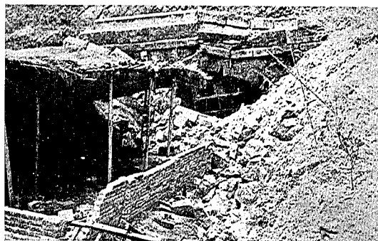
寫眞第五十二 崩壊甚だしくなる。(2月12日報)
