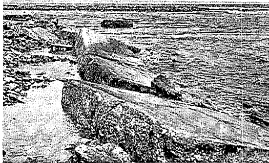
寫眞第三 八木。海岸の町村工事に依つて築造された船溜り用の混凝土護岸(壁の高さ約 1.8 m, 厚さ根本に於て約 1.0 m, 天端に於て 0.5 m) の一部は引き浪の爲に外方に倒された。
