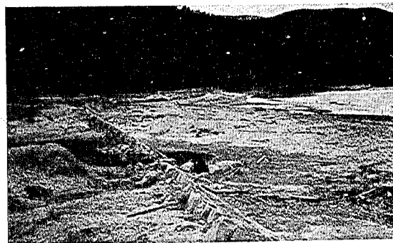
寫眞第七十八 大原村谷川。道路兼用の堤防（外面のみ空積間知を施す）殆ど流失。堤體は粘土分渺なき砂より成る。
