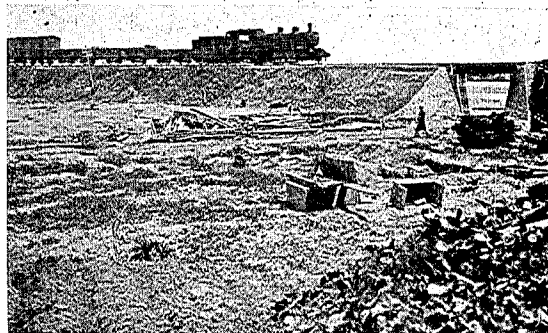
寫眞第二 八木。寫眞の右に見える鐵橋のある築堤の切れ目より津浪の出入があり内部住宅地に相當の被害を與へ且つこの稻藁裏の土が洗はれて鐵道一時不通の原因となつた。
