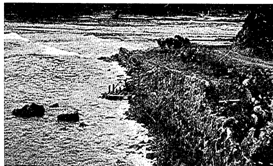
写真第四十三 小白濱片岸間知護岸。写真四十二の護岸の一端の破壊した一部。
