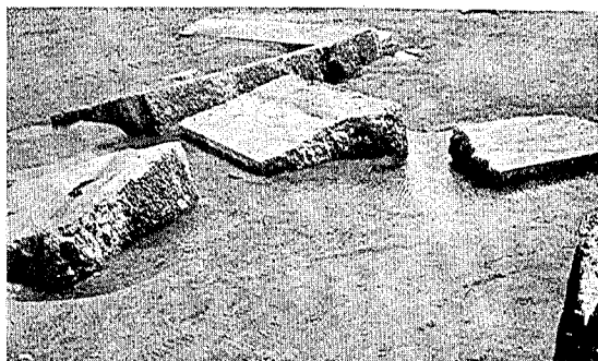
寫眞第四 八木。船溜り用護岸。寫眞の右端前方には舊位置に残つた壁が見える。中央にある混凝土ブロックは引き浪により倒され破壊散亂して流れ出た裏込土砂の中に埋つたもの。
