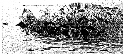
第 14 圖 津浪後の内港防波堤 (9月27日撮) 頭部混凝土方塊の轉落。向つて左方が港内
