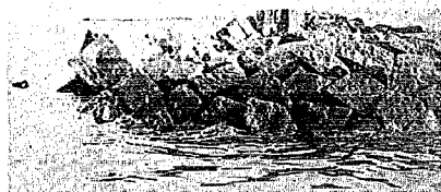
第 14 圖 津浪後の内港防波堤 (9月27日撮) 頭部混泥土方塊の轉落。向つて左方が港内
