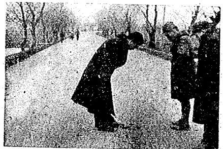
寫眞-16 (アスファルト鋪装の破損個處の調査)
