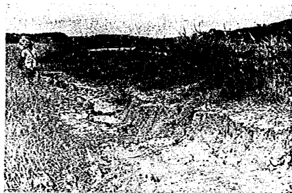
寫眞—54 大聖寺川堤防龜裂(右岸)
