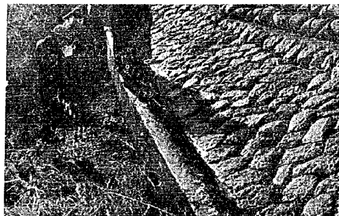
写真-3.8(b) 長島海岸堤防裏のり崩壊状況
