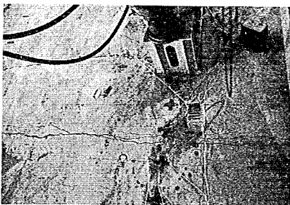
写真-11 床版の押抜きせん断破壊 (実験 No. 11)
