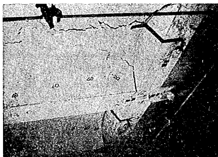
写真-3.2 破壊状況 (底面)
