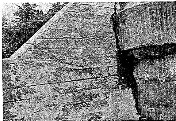
Photo 14 Crack of concrete Retaining Wall コンクリート擁壁の亀裂
