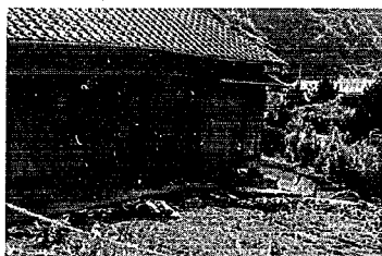
写真 2-3 斜面のすべりによる家屋被害 (㊸地点) (文献 2) による)
