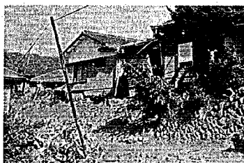
写真 2-4 斜面のすべりによる家屋被害 (㊹地点) (文献 2) による)
