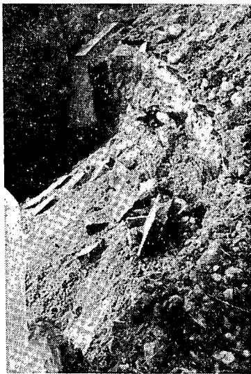
写真-6・2 盛土の崩壊(修善寺下田線, 梨本)
