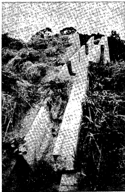
写真-4・2 湯ヶ野急傾斜地 (縦水路のずれ)
