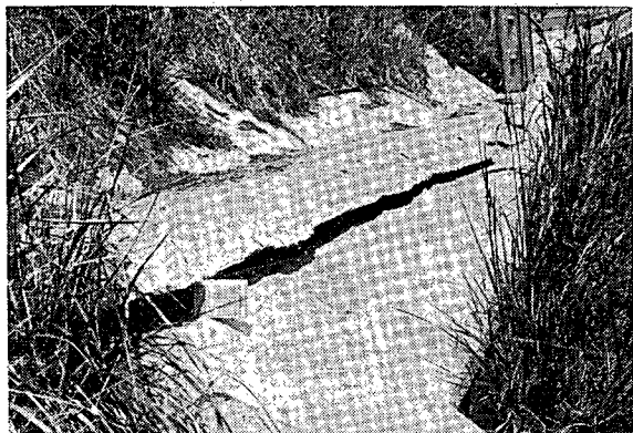
写真-4・1(d) 向井急傾斜地 (小段天端コンクリートの前ずれ)
