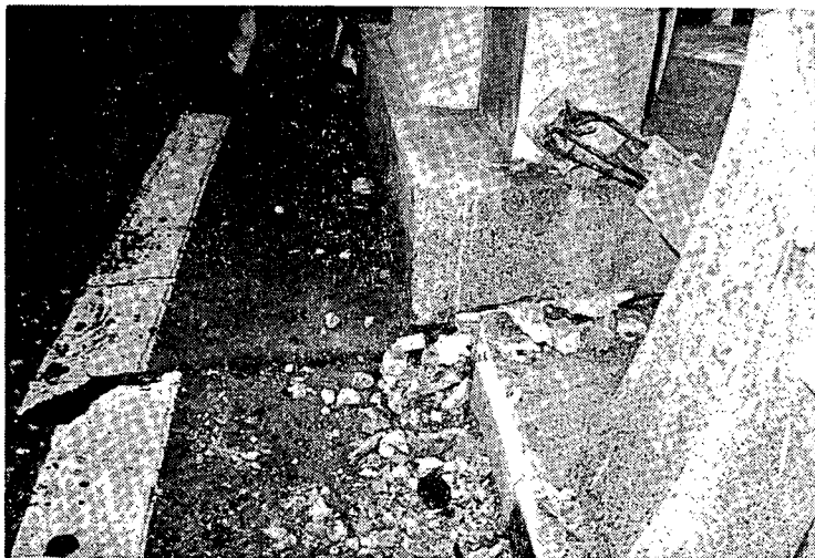
写真-7・19 新下田橋橋桁の横ずれ
