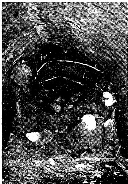
写真一7・12 城東トンネル内の落盤
