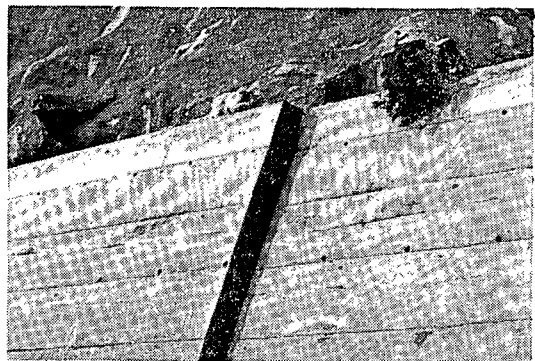
写真—5・2 擁壁のずれ (災害査定第2号地点)
