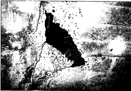
写真-7.46 覆工コンクリートの欠落 (30cm×30cm)
