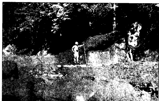
写真-6.3 泥流により本体を破壊された治山ダム
