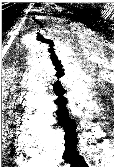
写真-7.4 路面の亀裂 (県道越木曽福島線)
