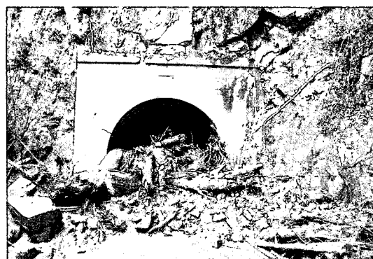
写真-7.44 水ヶ瀬トンネルの埋塞状況 (松越側入口から)
