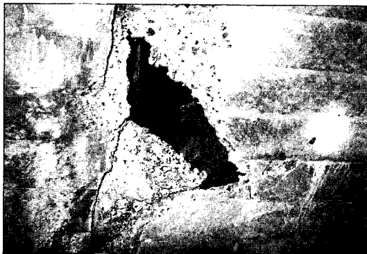
写真-7.46 覆工コンクリートの欠落 (30cm×30cm)
