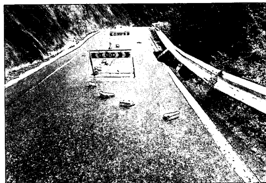
写真-7.15 西野川橋下 被災状況
