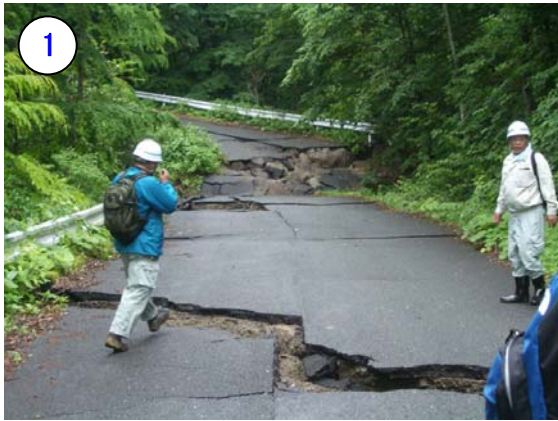
写真-2.11 道路を横断する開口亀裂 (2008年6月21日撮影)
