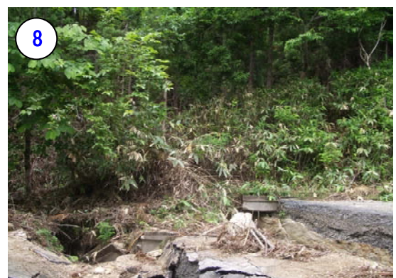
写真-2.10 道路に斜交する沢 (2008年6月22日撮影)
