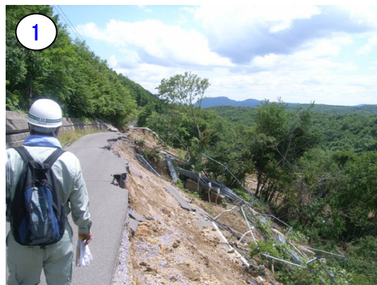
写真-2.32 頭部滑落崖（2008 年 7 月 15 日撮影）
