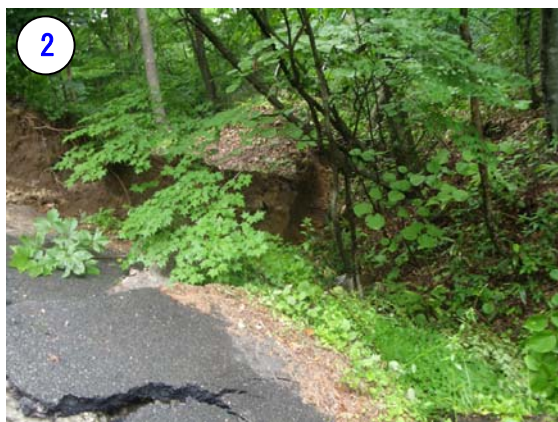
写真-2.12 引張り部に生じた陥没帯 (2008年6月21日撮影)
