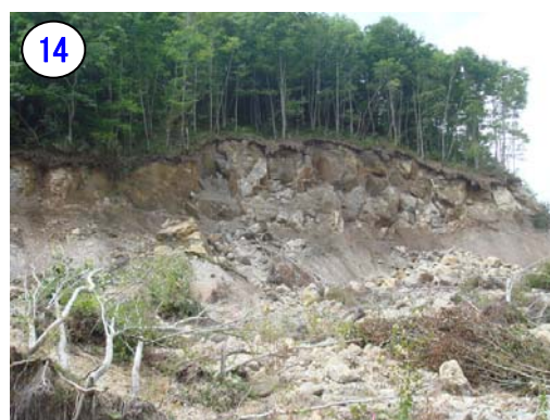
写真-2.26 頭部滑落崖 (2008年8月9日撮影)
