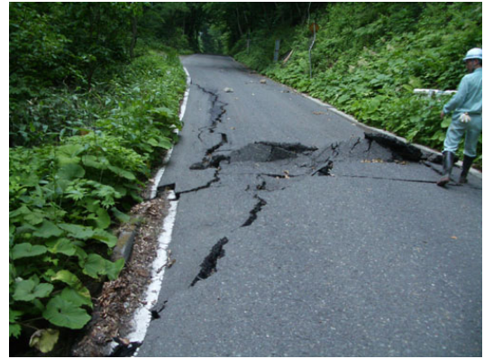
写真-2.45 T-17 地すべり（2008年6月22日撮影）
