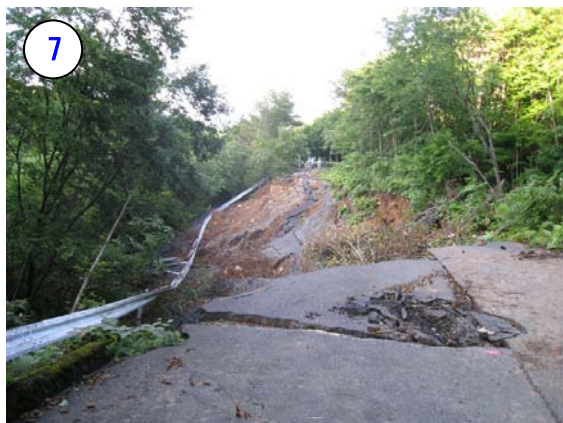
写真-2.17 現道の崩壊箇所 (2008年7月14日撮影)
