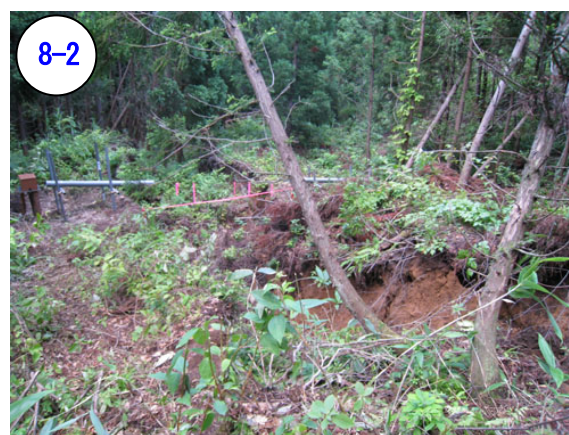
写真-2.19 滑落崖上部斜面の亀裂 (2008年7月14日撮影)
