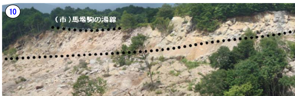
写真-2.22 崩壊地内から冷沢の左岸を撮影 (2008年8月9日撮影)
