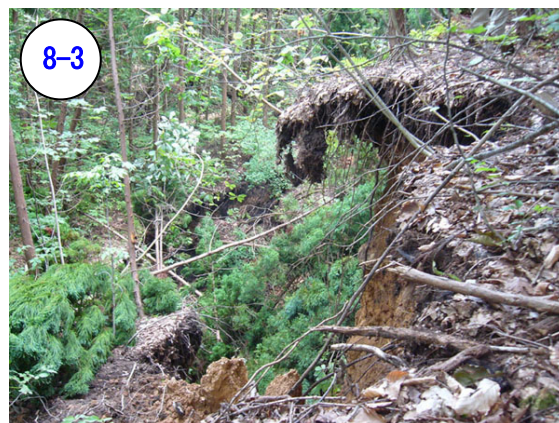
写真-2.20 地すべり地背後の亀裂 (2008年8月9日撮影)
