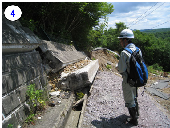
写真-2.35 滑落崖上部の擁壁の被災状況 (2008年7月15日撮影)
