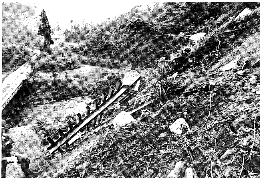
写真-3.6 基礎の移動および転倒
