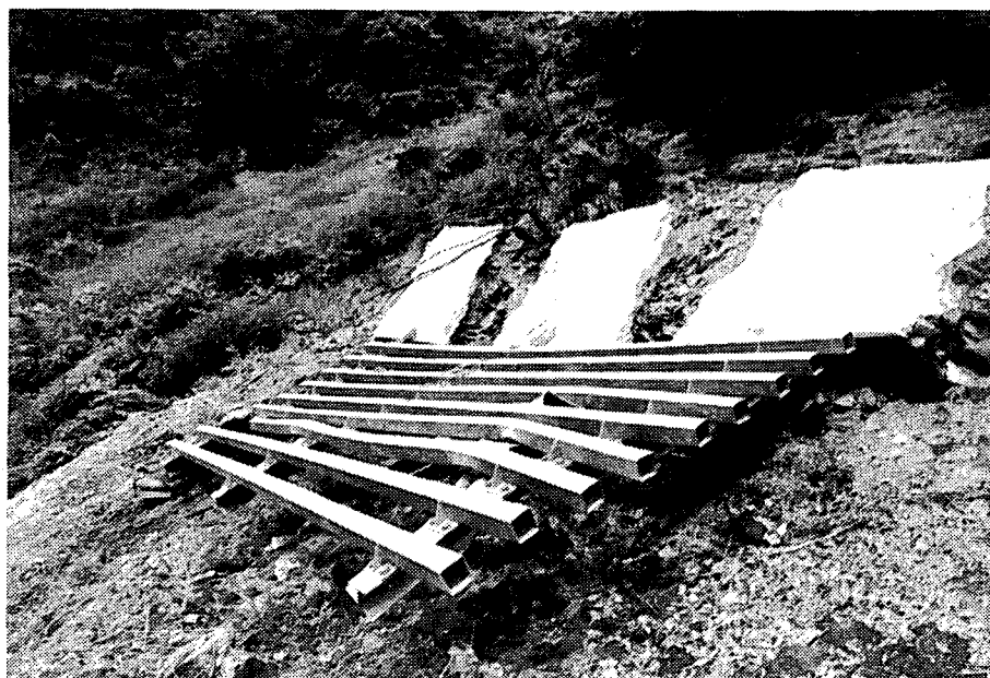
写真-3.5 基礎の破壊例
