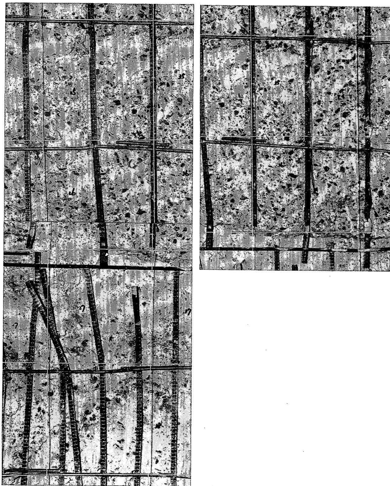
写真-1.1 鉄筋腐食状況 (その1)
