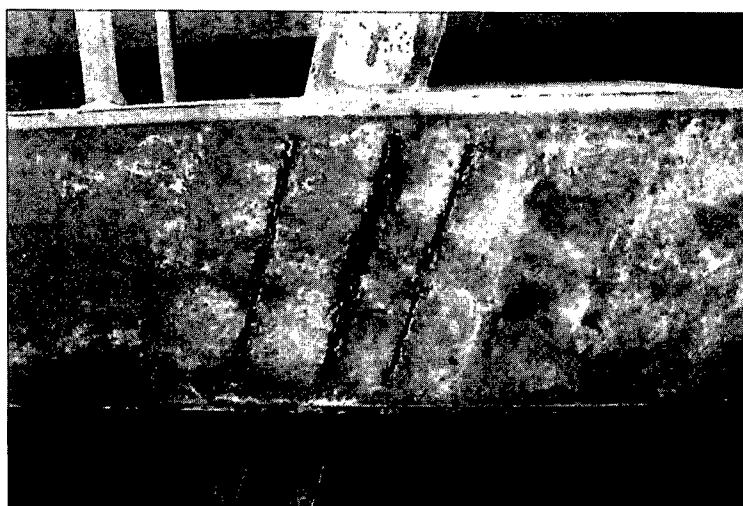
写真-2.3 主桁下面の鉄筋露出(損傷度Ⅱ) (写真-1と同じ橋)
