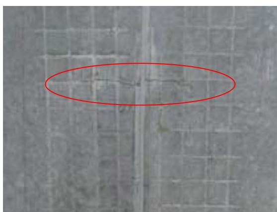
写真-3.4.12 張出し床版接合あご部ひび割れ
