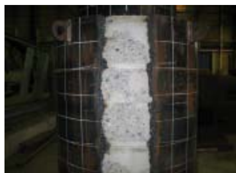
偏芯逆側拡大
