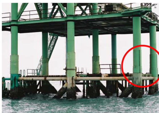
図－I－20 耐衝撃 FRP 保護カバーの暴露状況
