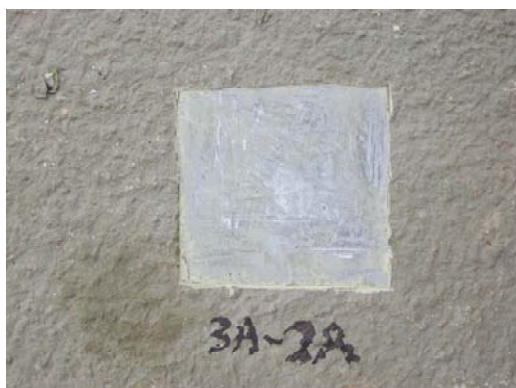
図－Ⅲ－８ 塗膜下鋼素地観察 No.6 : 有機ジンクリッチ／ エポキシ塗装系
