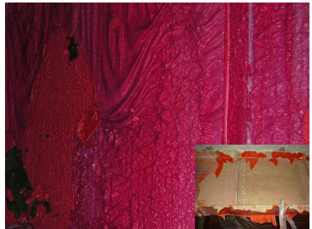
写真解－36 上層塗膜が軟化し一部脱落した例 (右下は、全面的にはく落した例)
