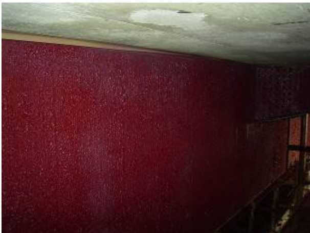
写真解－35 上層塗膜が大きく膨潤した例
