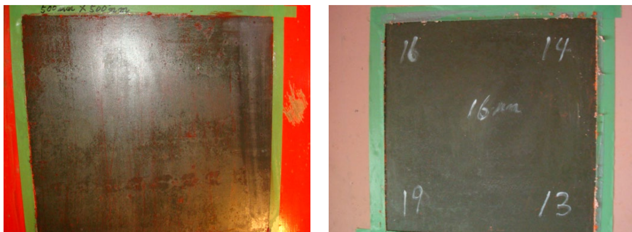
写真解-4 残存しているエッチングプライマー
