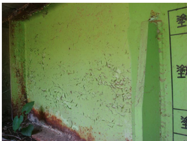
写真解-27 付着している汚れ
