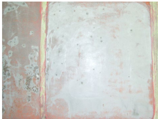
写真解-6 劣化したジンクリッチプライマー
