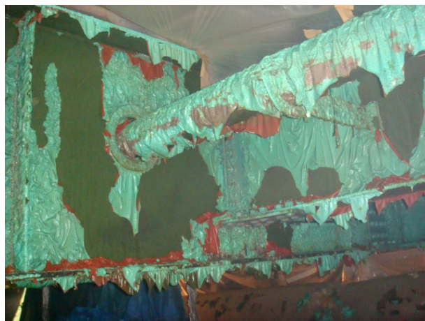
写真解－38 塗膜が自重で落下した例
