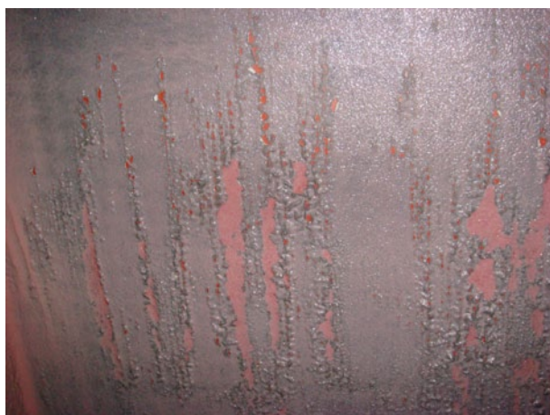
写真解-43 浮き塗膜が存在する状態
