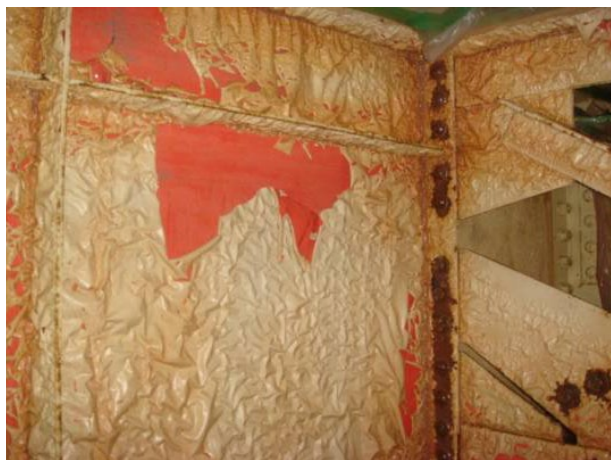
写真解－37 ポリウレタン樹脂塗膜が落下した例
