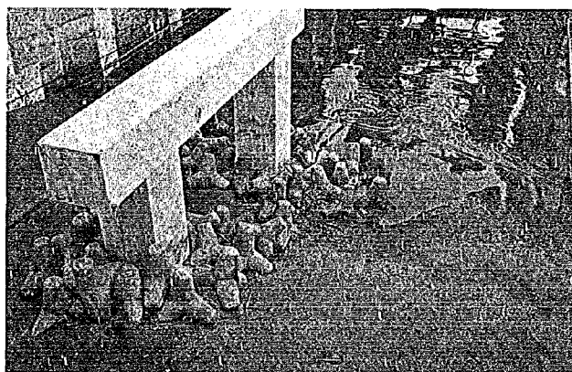
写真-3 ブロック散乱状況
