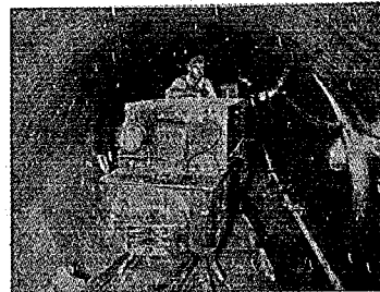
Fig 5-16 小トンネルでのバッテリー機関車
