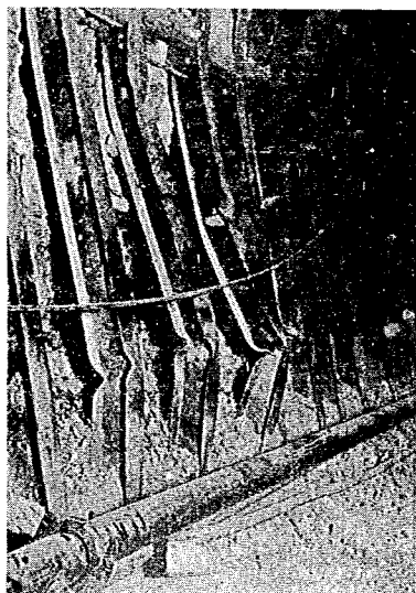
Fig. 125 鋼リブの未加工部分で の破壊
