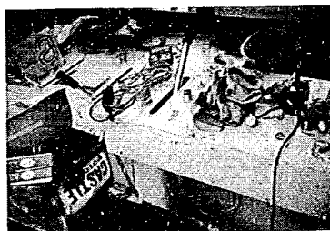
写真-68 運転制御盤
