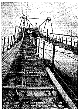
写真一63 作業用足場の床金網
