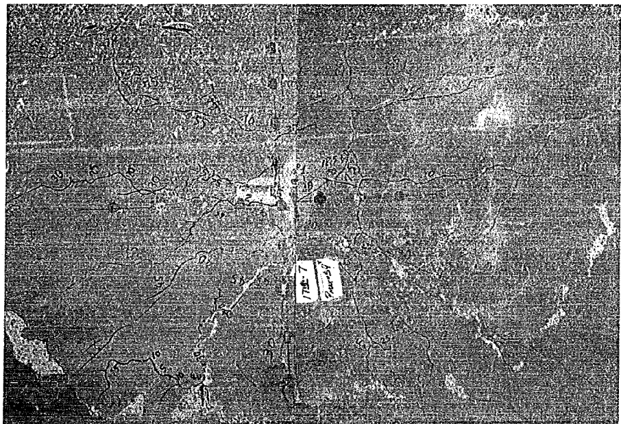
写真 5.1(f) 床版下面のひびわれ破損状況（端支間：⑦）
