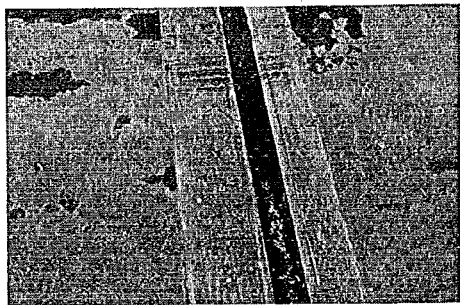
写真-62 三十木橋 ジョイント部分
