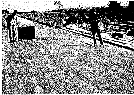
写真-11 交通量250台の路面状態(砂質土)
