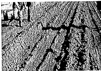
写真-4 交通量100台の路面状態(未改良関東ローム)
