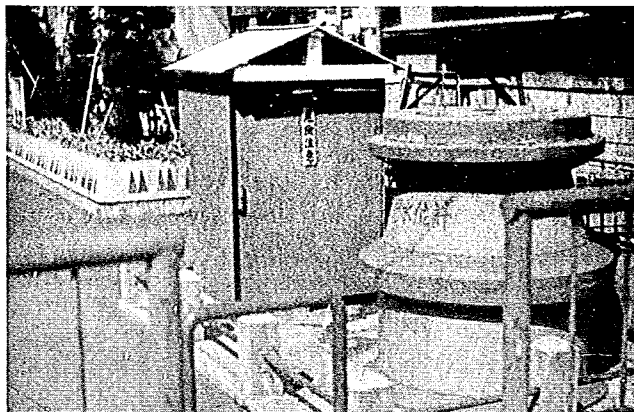
写真－3 桃園川上流水位観測所
