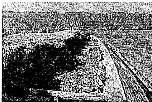
写真-9 久万川堤防（裏法洗掘 右が浦戸湾）
