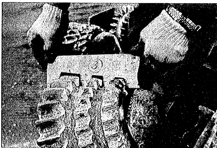
写真-5 カッタの摩耗状況
