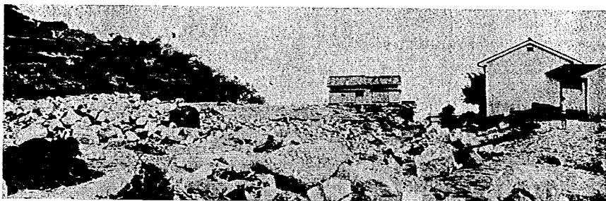
写真-2 下流部の被災状況
