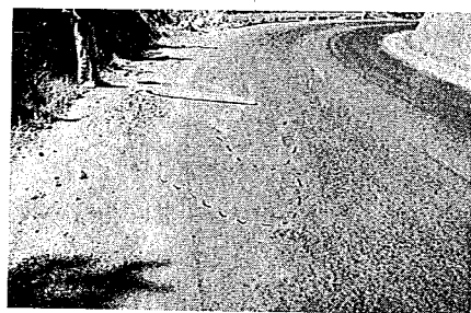
写真-3 はく離による混合物の匍匐現象
