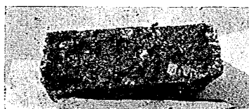
写真-1 はく離した混合物の状態 注) 下ははく離していない混合物
