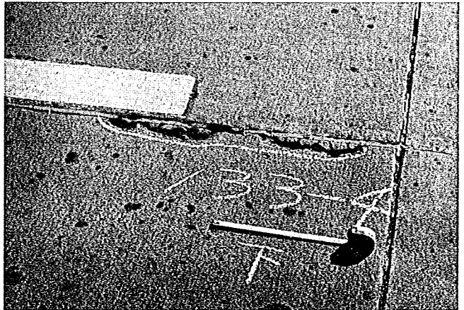
写真-2 縦目地の角欠け
