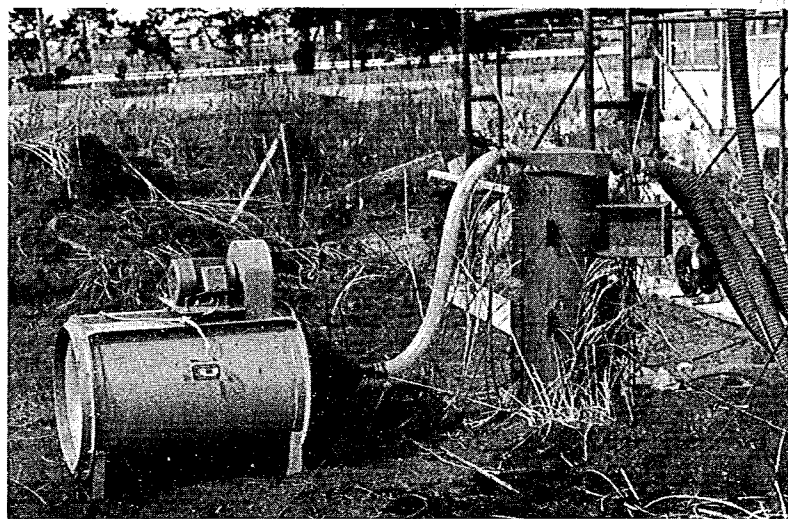
写真-5 送風機，送気ホース，分岐管
