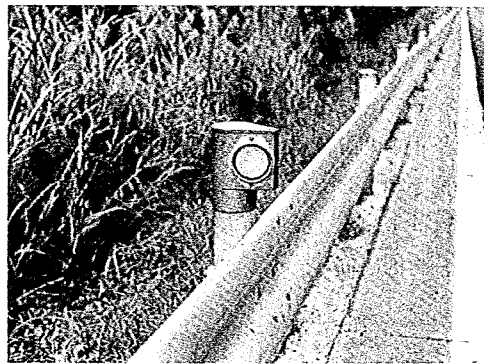
写真-5 ガードレールの支柱の頭部につけられたデリニエーター
