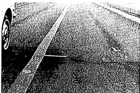
急勾配部分の橋軸直角方向スプライスプレートとおもわれる箇所は全て巾50 cm程のたて流れが発生している
