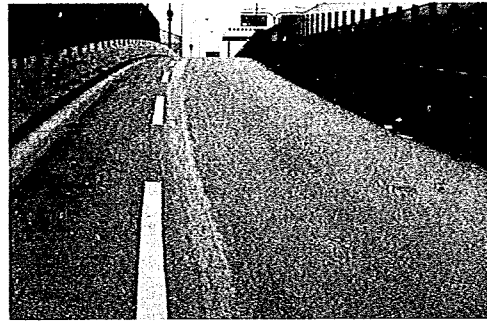
坂路部はわずかにわだち掘れ及びマモウを感じ る程で良好な状態である
