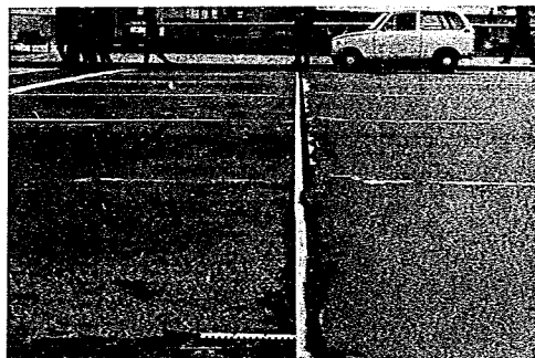
横断歩道手前は制動荷重をうけるため、たて 流れし、ジョイントにかぶさっている
