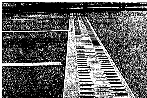
橋型ジョイント取付部はやゝ開きがみとめら れるが、まあまあの状態
