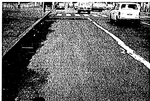
路端への側方流動はみられるが供用性に支障 はない レーンマークに流動をみとめるが、 レーンマークがなければ判らない(制動区間 のレーンマーク流動が大)
