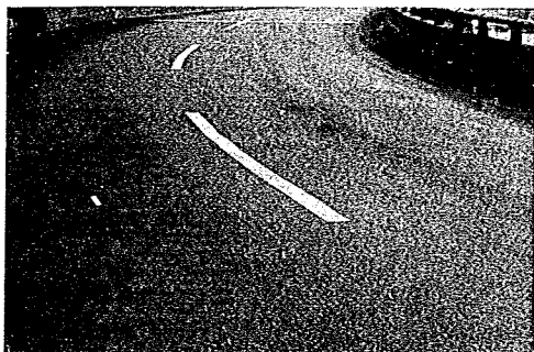
カントの急な部分の外側も線状クラックと6m程のワダチ掘れしているが内側にくらべ小さい(回転半径の差?)
