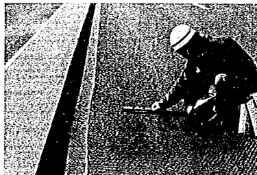
合材のバラツキが原因とおもわれる流動箇所
