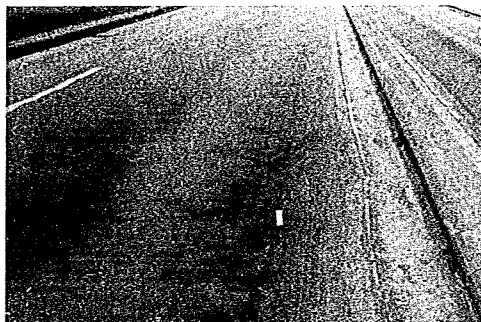
平坦部表層の1部は側方に流動した箇所あり
