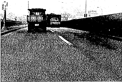
右路肩は幅約80cmのグースであるが、静 止荷重をうけるため流動している
