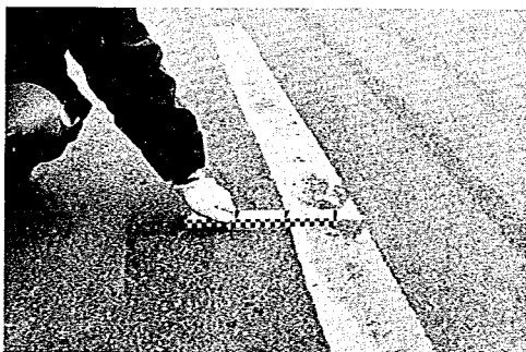
平坦部 レーンマーク沿いに全線にわたって 3 mm 前後のわだち掘れをみとめる
