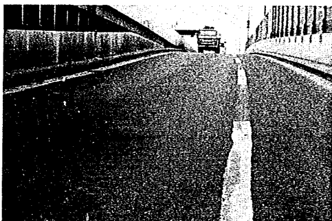
坂路の鋼床版の継手上とおもわれるたて流れ 発生している外縦リップ上の線状クラックもみ られる
