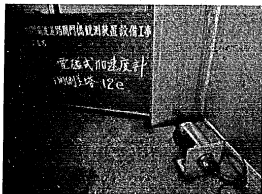
写真-3 電磁式加速度計（下関側主塔）
