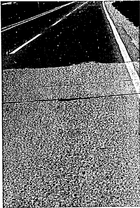
写真-1 損傷を受けた路面の一例
