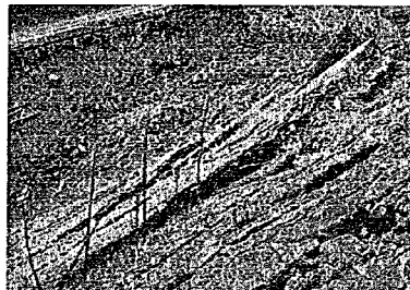
写真-2 崩壊のり面の鋸歯状状態
