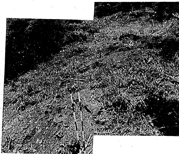
写真-4 崩積土の滑落 (基盤との境界) 2-(2)-a (長崎)
