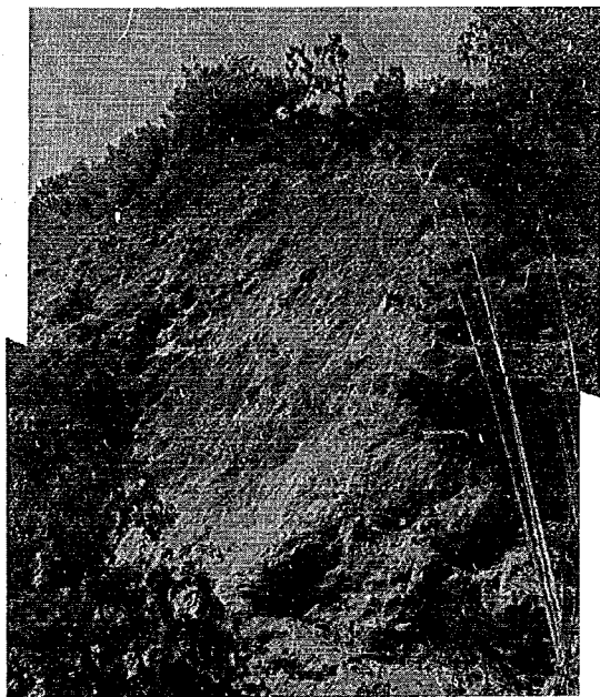
写真-7 火山碎屑物の崩落（集塊岩，凝灰角礫岩等） 3-(1)-b （山梨）
