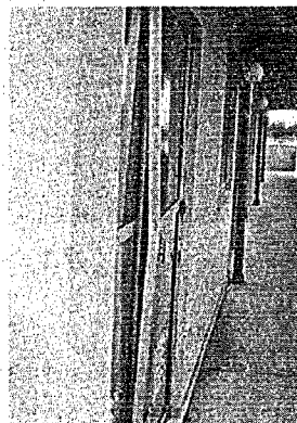
写真-8 風圧で曲がってしまった窓枠 (八丈高校)
