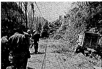
写真-2 田野一庄内線の切土面の崩壊
